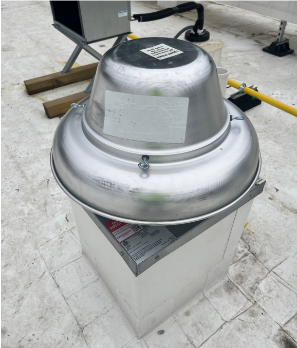
Restroom Exhaust Fan
