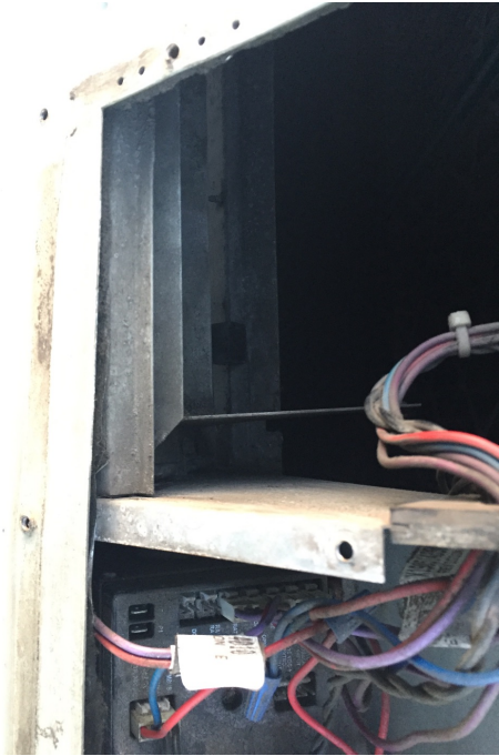
RTU 1 OA Damper
