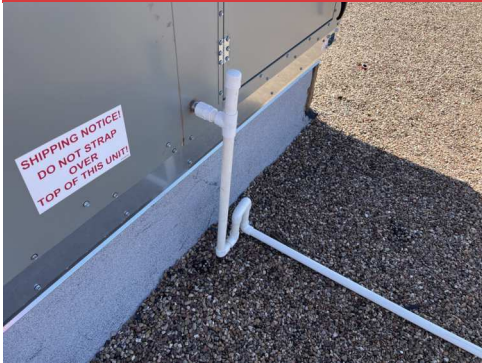
DOAS CONDENSATE DRAIN
