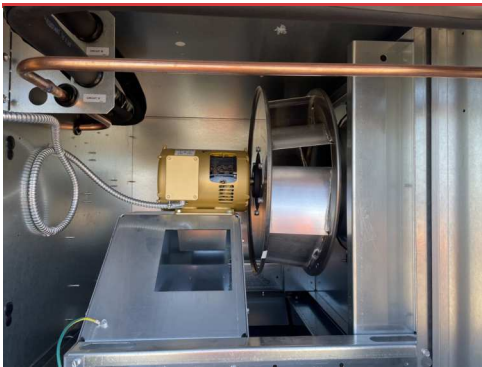
DOAS MOTOR AND FAN
