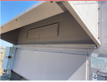
RTU4 O/A INTAKE
