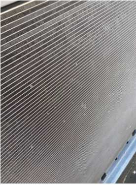
RTU-2 CONDENSER DIRTY
