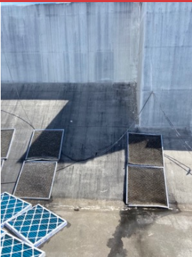
RTU-3 OA CLEAN
