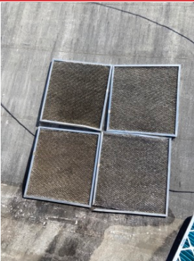
RTU-2 OA CLEAN
