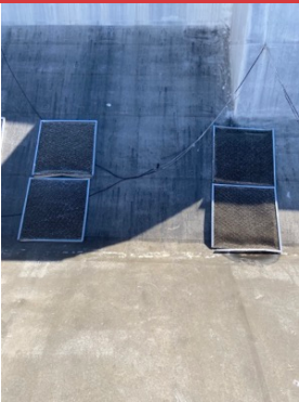
RTU-3 OA DIRTY
