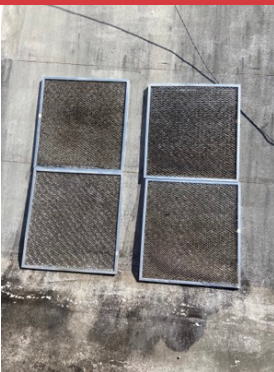
RTU-1 OA CLEAN
