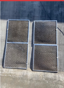
RTU-1 OA DIRTY
