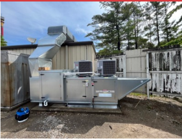
MAKE UP AIR FAN
