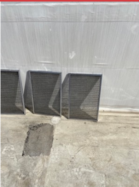
RTU-3/DOAS OA FILTERS CLEAN
