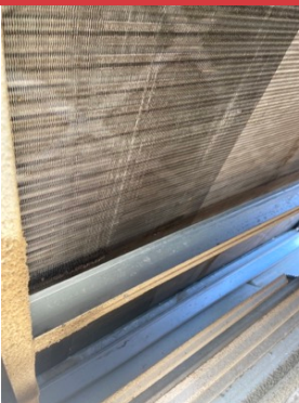
RTU-3/DOAS EVAP COIL DIRTY
