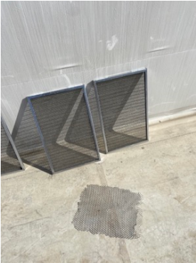
RTU-3/DOAS OA FILTERS DIRTY
