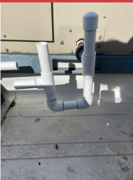
RTU-3/DOAS CONDENSATE DRAIN
