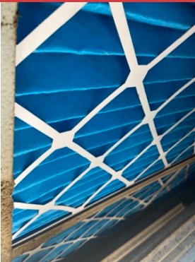
RTU-3/DOAS EVAP FILTERS CLEAN
