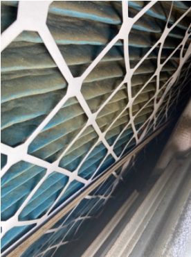
RTU-3/DOAS EVAP FILTERS DIRTY
