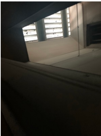
OA INTAKE LOUVER
