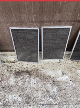
RTU-2 OA CLEAN
