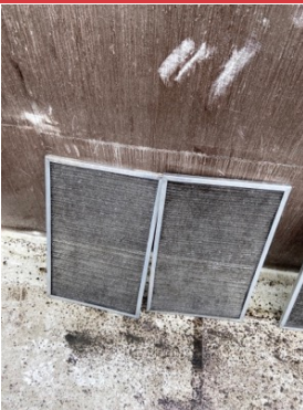
RTU-1 OA DIRTY
