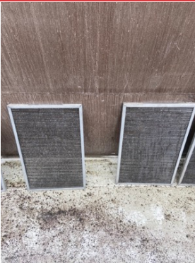
RTU-2 OA DIRTY
