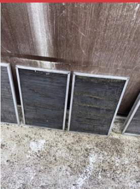
RTU-3 OA DIRTY
