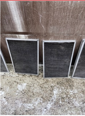
RTU-3 OA CLEAN
