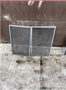
RTU-1 OA CLEAN
