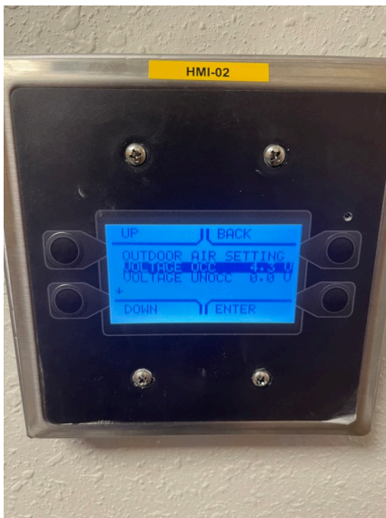
RTU-2 OA damper position
