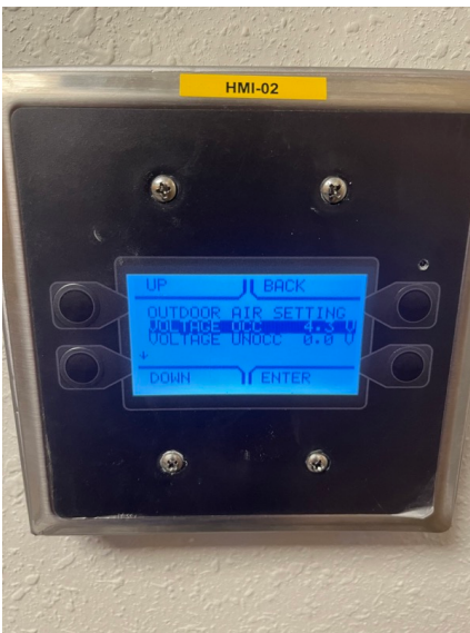
RTU-2 OA damper position
