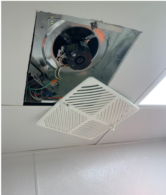
Ceiling Mop Fan
