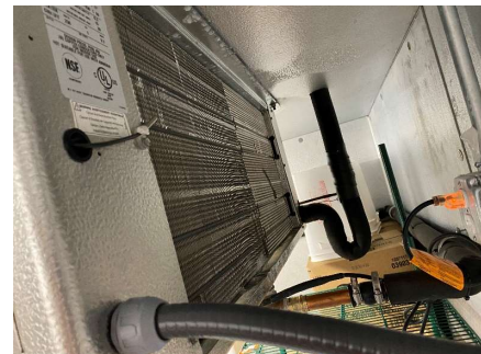
DXC-2 (WALK-IN FREEZER) CLEAN EVAPORATOR
