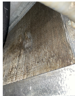
DXC-1 (WALK-IN COOLER) CLEAN EVAPORATOR
