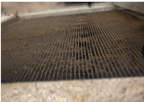
DXC-1 (WALK-IN COOLER) DIRTY EVAPORATOR
