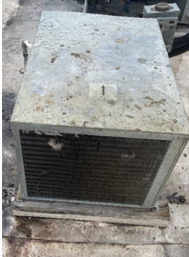
DXC-1 (WALK-IN COOLER) DIRTY CONDENSER
