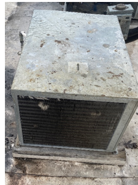
DXC-1 (WALK-IN COOLER) CLEAN CONDENSER
