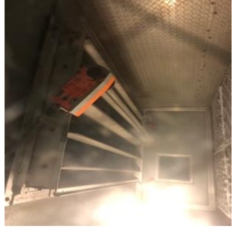
AHU OA Damper
