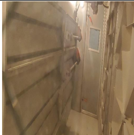
AHU OA Damper
