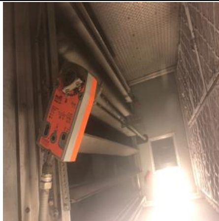
AHU OA Damper
