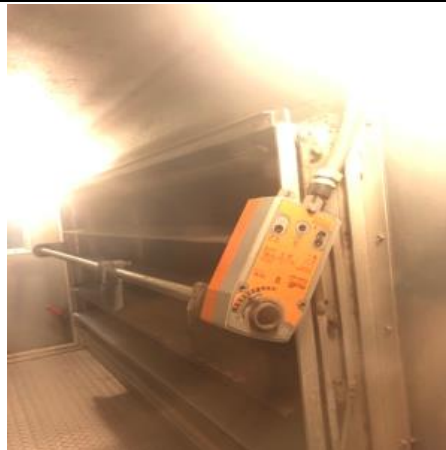
AHU OA Damper
