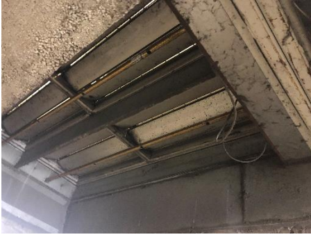
AHU OA Damper 1
