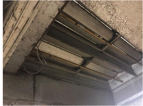
AHU OA Damper 4
