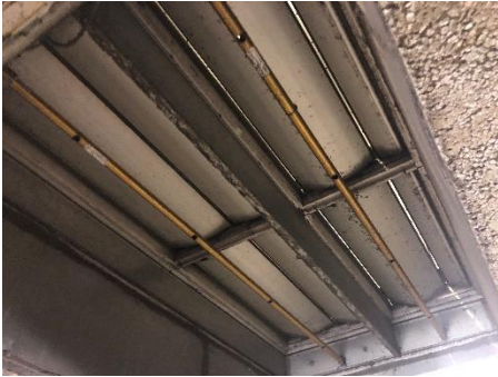
AHU OA Damper 3
