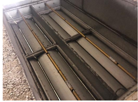
AHU OA Damper 2
