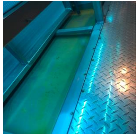
AHU Condensate Pan
