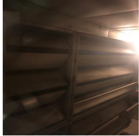
AHU OA Damper
