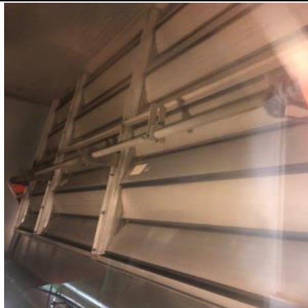
AHU OA Damper
