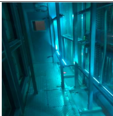
AHU Condensate Pan
