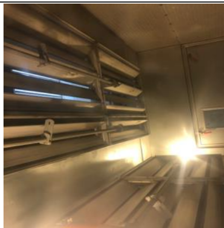
AHU OA Damper
