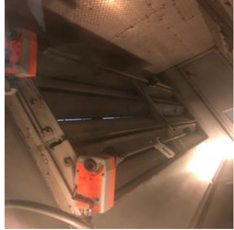
AHU OA Damper
