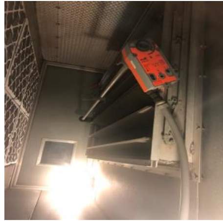
AHU OA Damper
