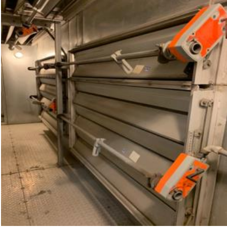
AHU OA Damper
