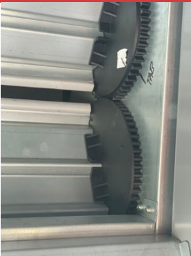
RTU2 OA SETPOINT
