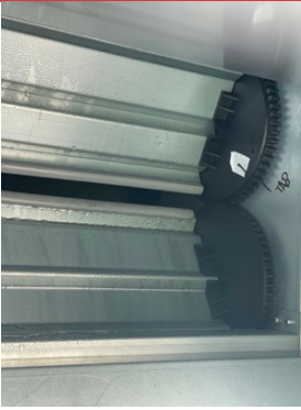
RTU3 OA SETPOINT
