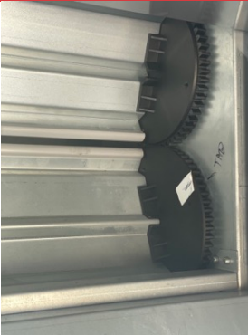
RTU4 OA SETPOINT
