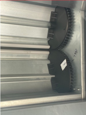
RTU4 OA SETPOINT
