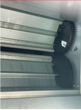
RTU3 OA SETPOINT
