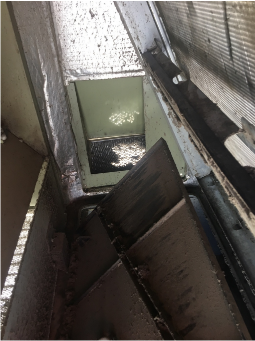
RTU-1,3 MIXED AIR
