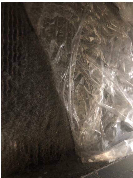
Prep Table 1 Dirty condenser
