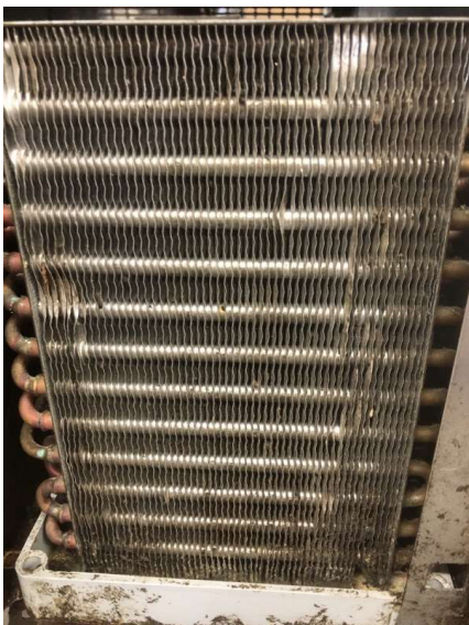
Prep Table 1 Dirty condenser
