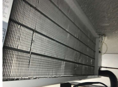
DXC-1 (WALK-IN FREEZER) CLEAN EVAPORATOR
